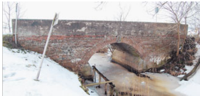
Die Brücke am Hansweg in Norden ist marode und soll durch einen Neubau ersetzt werden.
