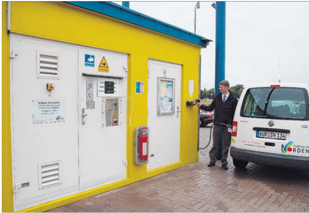
An der Erdgastankstelle an der Heerstraße gibt es bislang lediglich eine Zapfsäule. Das soll sich mit der Erweiterung ändern. Der Container, an dem Jan Markus steht, wird nach Norddeich versetzt.
